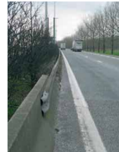
Vangrails die op deze wijze bevestigd zijn verzwaren de ernst van eventuele ongevallen met motorrijders. De vangrail moet naadloos aansluiten op het betonblok.
