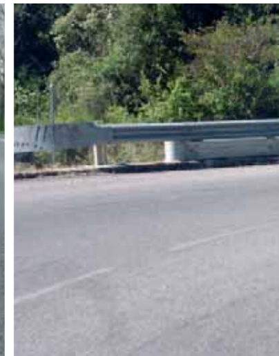
De uiteinden van de vangrail en van de beschermende plank werden afgerond. Bij voorkeur eindigt de beschermende plank op dezelfde hoogte als de vangrail.
